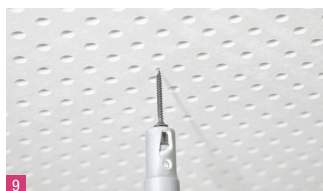
9 Předvrtaný montážní rastr z pohledové strany desky. Při použití vysoce akustických desek – rychlomontážní šroub Gold s RUSPERT vrstvou.
